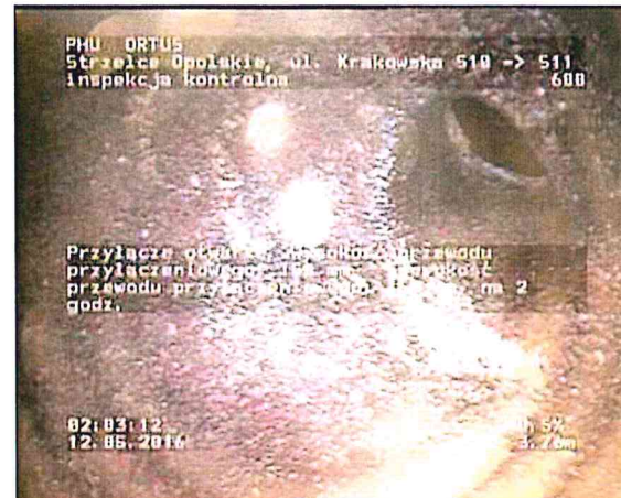
Zdjęcie: 12_3A, MPEG #: 080516_1, 00:01:19 3,76m, Przyłącze otwarte, Wysokość przewodu przyłączeniowego: 150 mm, Szerokość przewodu przyłączeniowego: 150 mm, na 2 godz.
