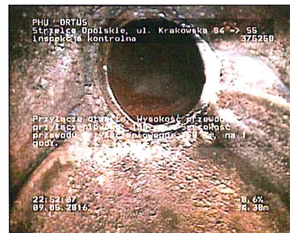
Zdjęcie: 5_5A, MPEG #: 080516_1, 00:05:49 34,3m, Przyłącze otwarte, Wysokość przewodu przyłączeniowego: 150 mm, Szerokość przewodu przyłączeniowego: 150 mm, na 1 godz.
