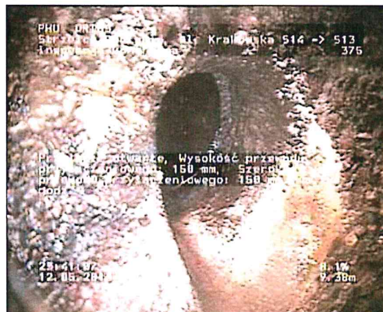
Zdjęcie: 13_4A, MPEG #: 080516_1, 00:02:26 9,38m, Przyłącze otwarte, Wysokość przewodu przyłączeniowego: 150 mm, Szerokość przewodu przyłączeniowego: 150 mm, na 10 godz.
