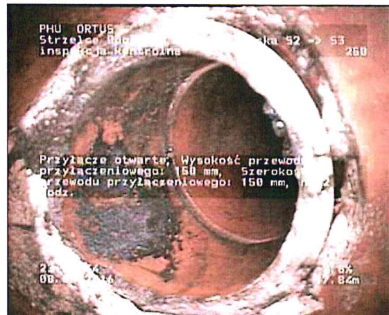
Zdjęcie: 3_3A, MPEG #: 080516_1, 00:02:59 17,84m, Przyłącze otwarte, Wysokość przewodu przyłączeniowego: 150 mm, Szerokość przewodu przyłączeniowego: 150 mm, na 2 godz.
