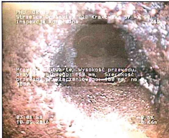
Zdjęcie: 8_2A, MPEG #: 080516_1, 00:00:40 0,44m, Przyłącze otwarte, Wysokość przewodu przyłączeniowego: 150 mm, Szerokość przewodu przyłączeniowego: 150 mm, na 2 godz.
