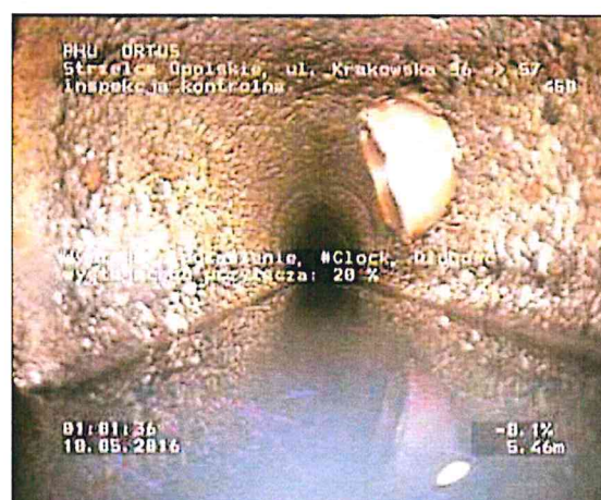
Zdjęcie: 7_5A, MPEG #: 080516_1, 00:02:28 5,46m, Wystające połączenie, #Clock, Długość wystającego przyłącza: 20 %
