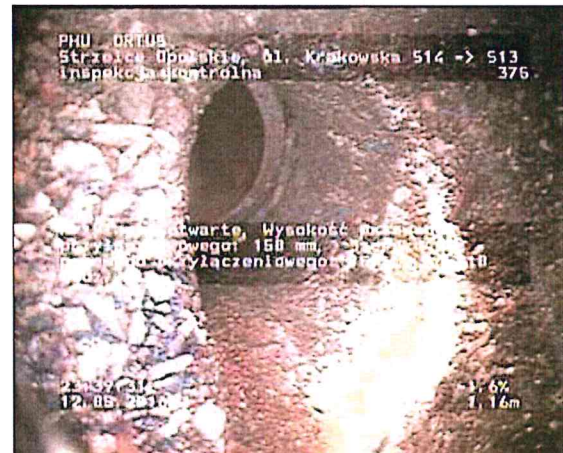
Zdjęcie: 13_3A, MPEG #: 080516_1, 00:01:03 1,16m, Przyłącze otwarte, Wysokość przewodu przyłączeniowego: 150 mm, Szerokość przewodu przyłączeniowego: 150 mm, na 10 godz.
