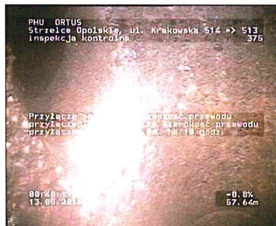
Zdjęcie: 13_19A, MPEG #: 080516_1, 00:22:10 57,64m, Przyłącze zamknięte, Wysokość przewodu przyłączeniowego: 150 mm, Szerokość przewodu przyłączeniowego: 150 mm, na 10 godz.
