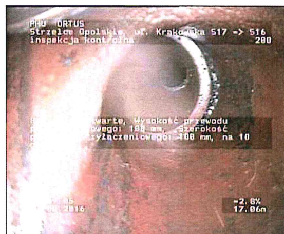
Zdjęcie: 16_7A, MPEG #: 080516_1, 00:04:04 17,06m, Przyłącze otwarte, Wysokość przewodu przyłączeniowego: 100 mm, Szerokość przewodu przyłączeniowego: 100 mm, na 10 godz.
