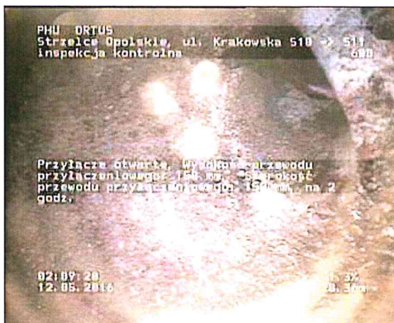
Zdjęcie: 12_8A, MPEG #: 080516_1, 00:05:58 28,36m, Przyłącze otwarte, Wysokość przewodu przyłączeniowego: 150 mm, Szerokość przewodu przyłączeniowego: 150 mm, na 2 godz.
