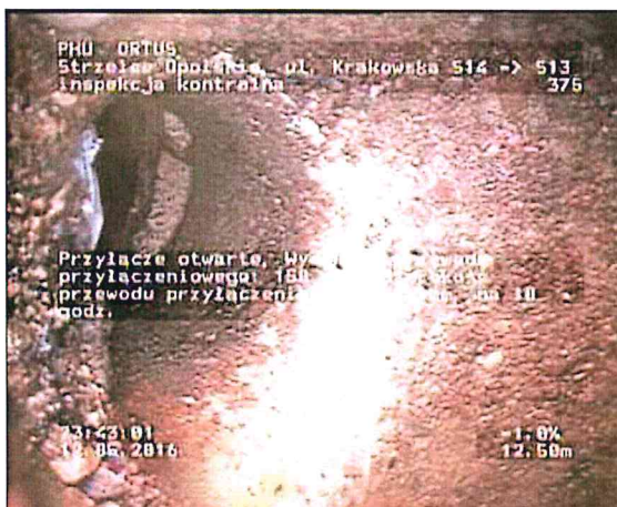
Zdjęcie: 13_6A, MPEG #: 080516_1, 00:03:44 12,5m, Przyłącze otwarte, Wysokość przewodu przyłączeniowego: 150 mm, Szerokość przewodu przyłączeniowego: 150 mm, na 10 godz.
