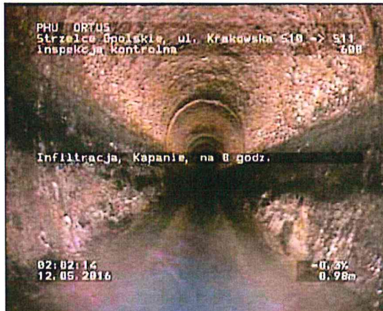
Zdjęcie: 12_2A, MPEG #: 080516_1, 00:00:40 0,98m, Infiltracja, Kapanie, na 8 godz.
