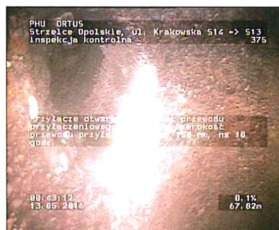
Zdjęcie: 13_21A, MPEG #: 080516_1, 00:24:27 67,82m, Przyłącze otwarte, Wysokość przewodu przyłączeniowego: 150 mm, Szerokość przewodu przyłączeniowego: 150 mm, na 10 godz.
