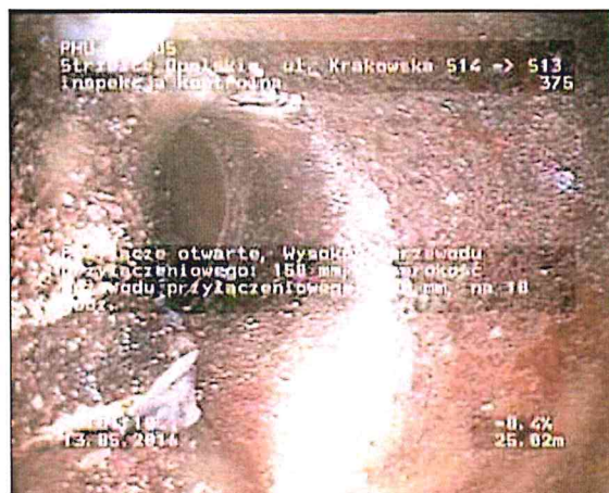
Zdjęcie: 13_10A, MPEG #: 080516_1, 00:08:54 25,02m, Przyłącze otwarte, Wysokość przewodu przyłączeniowego: 150 mm, Szerokość przewodu przyłączeniowego: 150 mm, na 10 godz.
