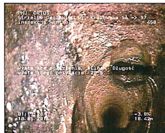
Zdjęcie: 7_9A, MPEG #: 080516_1, 00:07:53 18,42m, Wystające połączenie, #Clock, Długość wystającego przyłącza: 20 %
