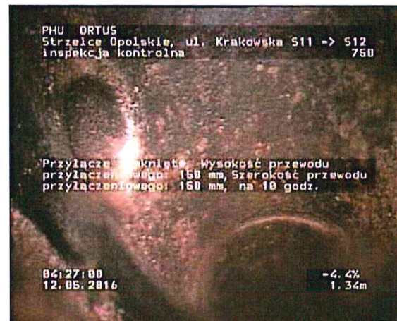
Zdjęcie: 13_4A, MPEG #: 080516_1, 00:01:27 1,34m, Przyłącze zamknięte, Wysokość przewodu przyłączeniowego: 150 mm, Szerokość przewodu przyłączeniowego: 150 mm, na 10 godz.
