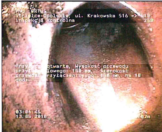
Zdjęcie: 15_10A, MPEG #: 080516_1, 00:10:31 51,02m, Przyłącze otwarte, Wysokość przewodu przyłączeniowego: 150 mm, Szerokość przewodu przyłączeniowego: 150 mm, na 10 godz.
