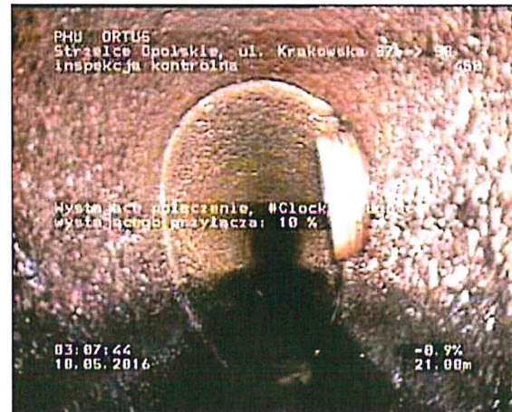
Zdjęcie: 8_7A, MPEG #: 080516_1, 00:05:08 21m, Wystające połączenie, #Clock, Długość wystającego przyłącza: 10 %
