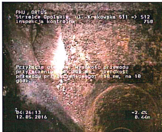
Zdjęcie: 13_3A, MPEG #: 080516_1, 00:00:56 0,44m, Przyłącze otwarte, Wysokość przewodu przyłączeniowego: 150 mm, Szerokość przewodu przyłączeniowego: 150 mm, na 10 godz.
