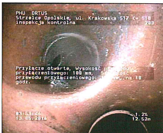
Zdjęcie: 17_6A, MPEG #: 080516_1, 00:03:27 12,52m, Przyłącze otwarte, Wysokość przewodu przyłączeniowego: 100 mm, Szerokość przewodu przyłączeniowego: 100 mm, na 10 godz.
