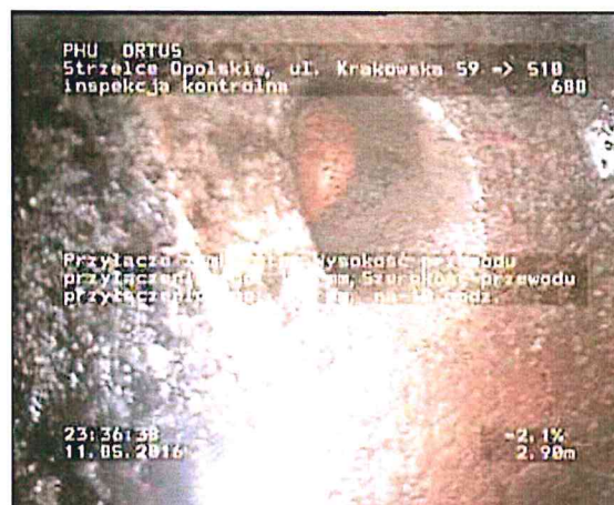
Zdjęcie: 11_3A, MPEG #: 080516_1, 00:01:07 2,9m, Przyłącze zamknięte, Wysokość przewodu przyłączeniowego: 150 mm, Szerokość przewodu przyłączeniowego: 150 mm, na 10 godz.
