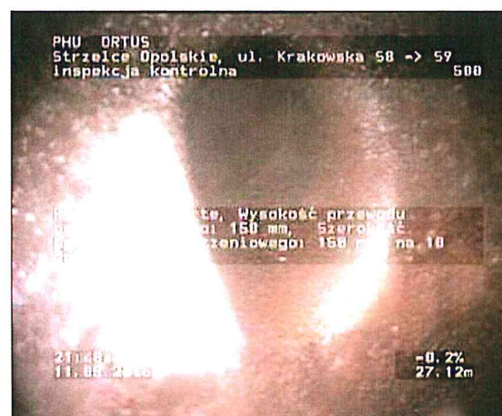
Zdjęcie: 9_9A, MPEG #: 080516_1, 00:11:26 27,12m, Przyłącze otwarte, Wysokość przewodu przyłączeniowego: 150 mm, Szerokość przewodu przyłączeniowego: 150 mm, na 10 godz.
