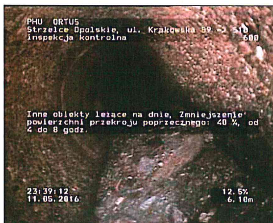
Zdjęcie: 11_4A, MPEG #: 080516_1, 00:02:20 6,1m, Inne obiekty leżące na dnie, Zmniejszenie powierzchni przekroju poprzecznego: 40 %, od 4 do 8 godz.
