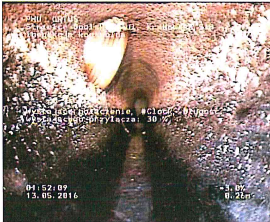
Zdjęcie: 14_2A, MPEG #: 080516_1, 00:00:31 0,26m, Wystające połączenie, #Clock, Długość wystającego przyłącza: 30 %
