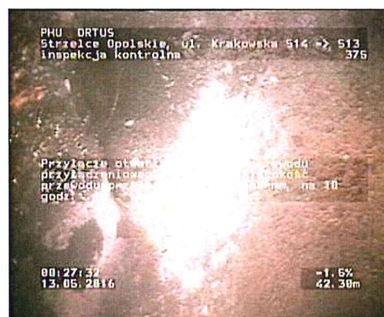
Zdjęcie: 13_13A, MPEG #: 080516_1, 00:15:37 42,3m, Przyłącze otwarte, Wysokość przewodu przyłączeniowego: 150 mm, Szerokość przewodu przyłączeniowego: 150 mm, na 10 godz.
