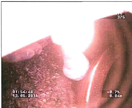
Zdjęcie: 14_4A, MPEG #: 080516_1, 00:01:55 0,84m, Rezygnacja z inspekcji, Przeszkoda
