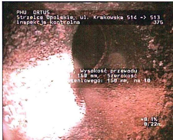
Zdjęcie: 13_2A, MPEG #: 080516_1, 00:00:34 0,22m, Przyłącze otwarte, Wysokość przewodu przyłączeniowego: 150 mm, Szerokość przewodu przyłączeniowego: 150 mm, na 10 godz.
