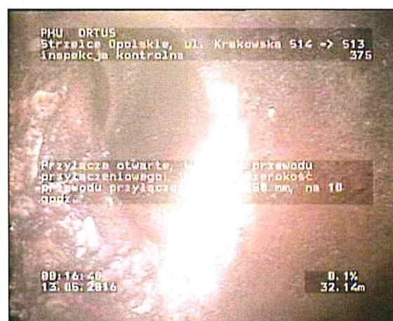
Zdjęcie: 13_12A, MPEG #: 080516_1, 00:12:09 32,14m, Przyłącze otwarte, Wysokość przewodu przyłączeniowego: 150 mm, Szerokość przewodu przyłączeniowego: 150 mm, na 10 godz.
