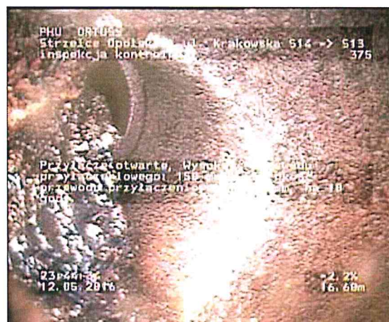
Zdjęcie: 13_7A, MPEG #: 080516_1, 00:04:58 16,6m, Przyłącze otwarte, Wysokość przewodu przyłączeniowego: 150 mm, Szerokość przewodu przyłączeniowego: 150 mm, na 10 godz.
