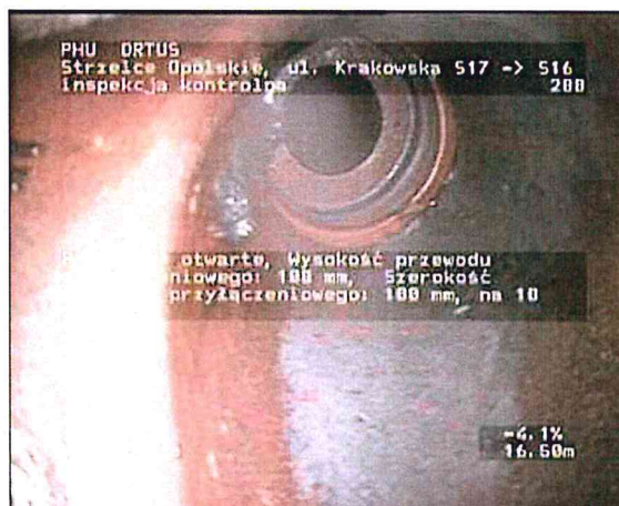
Zdjęcie: 16_6A, MPEG #: 080516_1, 00:03:35 16,5m, Przyłącze otwarte, Wysokość przewodu przyłączeniowego: 100 mm, Szerokość przewodu przyłączeniowego: 100 mm, na 10 godz.
