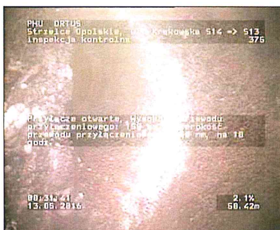
Zdjęcie: 13_16A, MPEG #: 080516_1, 00:18:56 50,42m, Przyłącze otwarte, Wysokość przewodu przyłączeniowego: 150 mm, Szerokość przewodu przyłączeniowego: 150 mm, na 10 godz.
