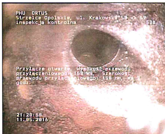
Zdjęcie: 9_2A, MPEG #: 080516_1, 00:00:32 0,46m, Przyłącze otwarte, Wysokość przewodu przyłączeniowego: 150 mm, Szerokość przewodu przyłączeniowego: 150 mm, na 2 godz.
