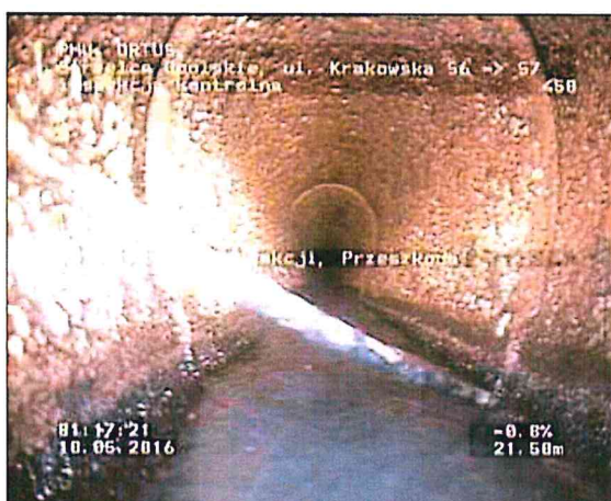
Zdjęcie: 7_12A, MPEG #: 080516_1, 00:10:31 21,5m, Rezygnacja z inspekcji, Przeszkoda
