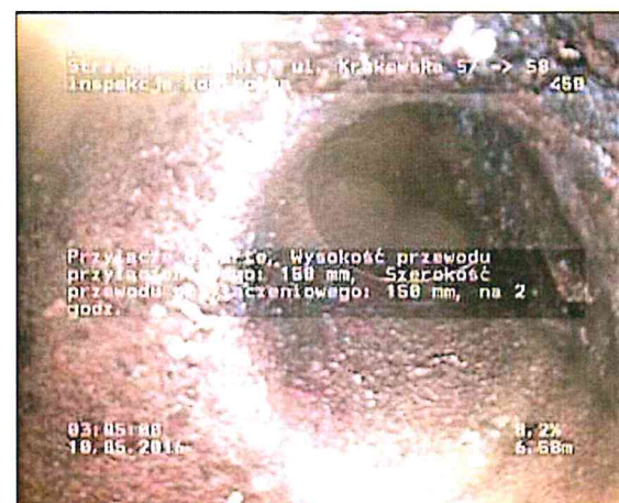
Zdjęcie: 8_5A, MPEG #: 080516_1, 00:02:52 6,58m, Przyłącze otwarte, Wysokość przewodu przyłączeniowego: 150 mm, Szerokość przewodu przyłączeniowego: 150 mm, na 2 godz.
