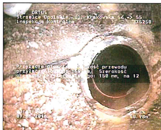
Zdjęcie: 5_9A, MPEG #: 080516_1, 00:11:32 58,98m, Przyłącze otwarte, Wysokość przewodu przyłączeniowego: 150 mm, Szerokość przewodu przyłączeniowego: 150 mm, na 12 godz.
